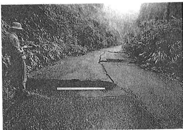
写真18. 鎌倉山北斜面(第2図g)の路面に生じた 圧縮破壊。 Photo. 18. Pressure destruction on the road at Loc. g on Fig. 2, at the northern part of Mt. Kamakura.
