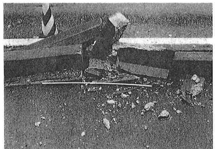
写真13. 笹畑付近（第8図e）縁石に生じた圧縮破壊。 Photo. 13. Pressure destruction of the concrete block line at Loc.e on Fig. 8.
