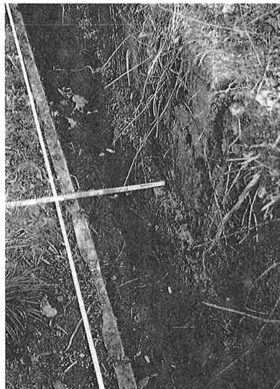
写真2. 賀祥ダム北側（第4図f地点）で観察されたU字溝の左シフト。 Photo. 2. Left lateral shift of the gutter at Loc. f on Fig. 4.
