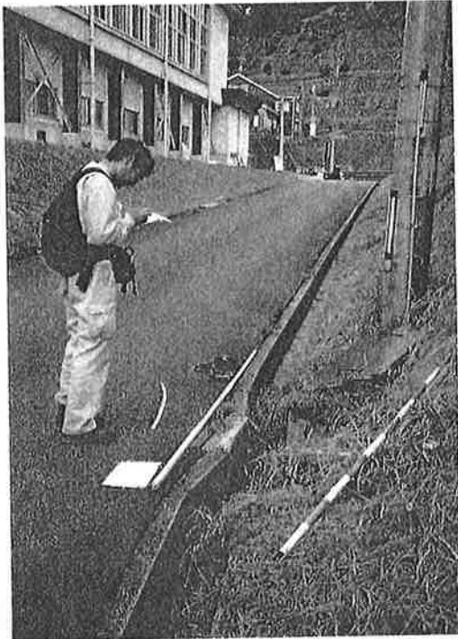
写真5. 緑水園付近（第6図）で観察された雨水升の座屈破壊。 Photo. 5. Compression buckling of the gutter at Ryokusui-en on Fig. 6.
